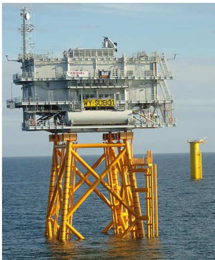
Rysunek 2.10. Morska stacja elektroenergetyczna na MFW Walney Phase 1 [Źródło: https://www.isc.dk/en/walney-i-ii-vindmoellepark/ ]
